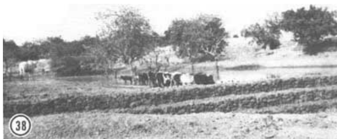
Photo 38: micro-barrage achevé: on remarque la disposition en escalier des couches de gabions successives.
