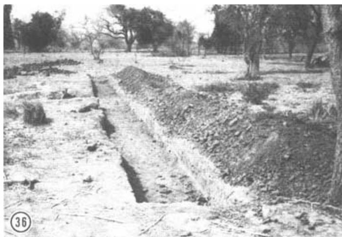
Photo 36: tranchée creusée en vue d'encastrier la première couche de gabions d'un micro-barrage. Le fond doit être bien plat et les côtés rectilignes.
