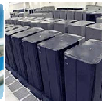
Infraestrutura de TI
