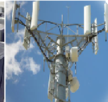
Infraestrutura de Comunicações
