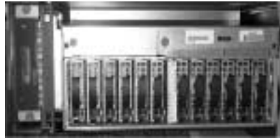
0595ラック搭載 ユニット
