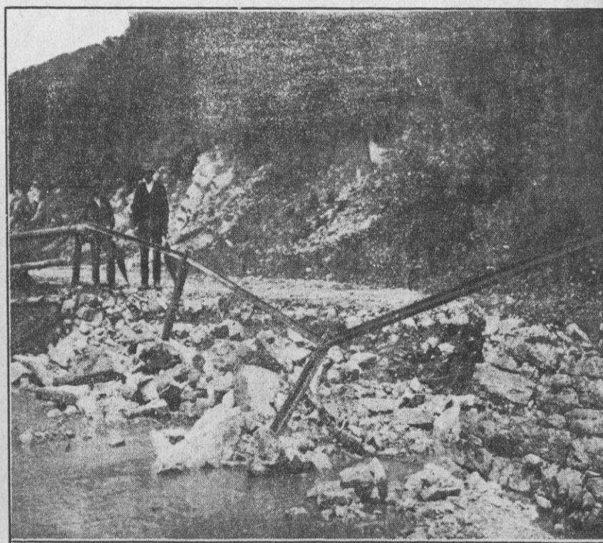
Porušena cesta v Jureču pri Brekovcah, ki veže Žiri z Logatcem.
