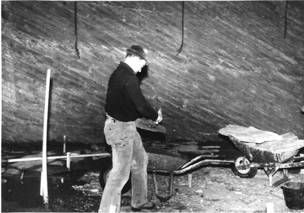
Schiefverlegung Innenraum Auferstehungskirche 1968
